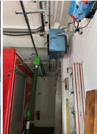
Heizungsgebläse (Feuerwehhaus Schlangenbad)
